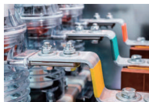
電源設備定期檢查、電源品質的監控
